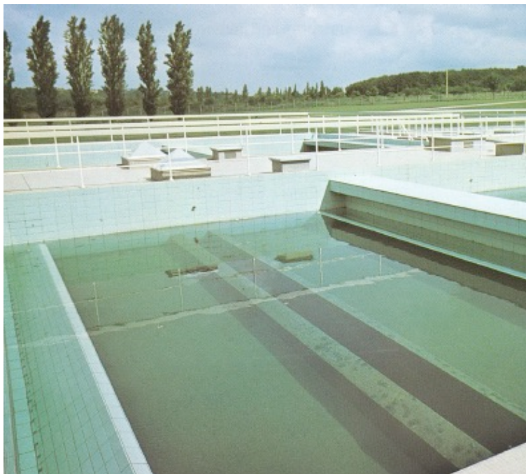
Filtro a sabbia in filtrazione
